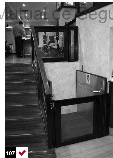
Foto 107: plataforma vertical instalada como opción a escalera. Santiago, Chile.
