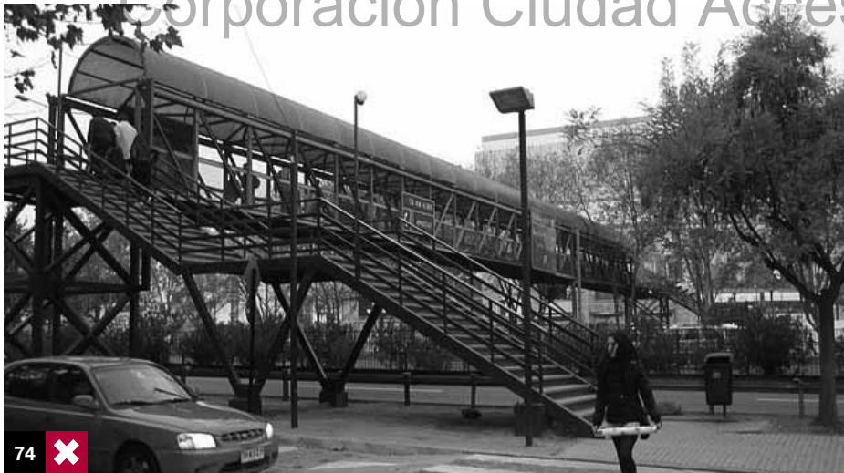
Foto 74: pasarela peatonal sobre autopista urbana sin posibilidad de cruce para personas con movilidad reducida. Autopista frente a Parque Arauco, Santiago, Chile.
